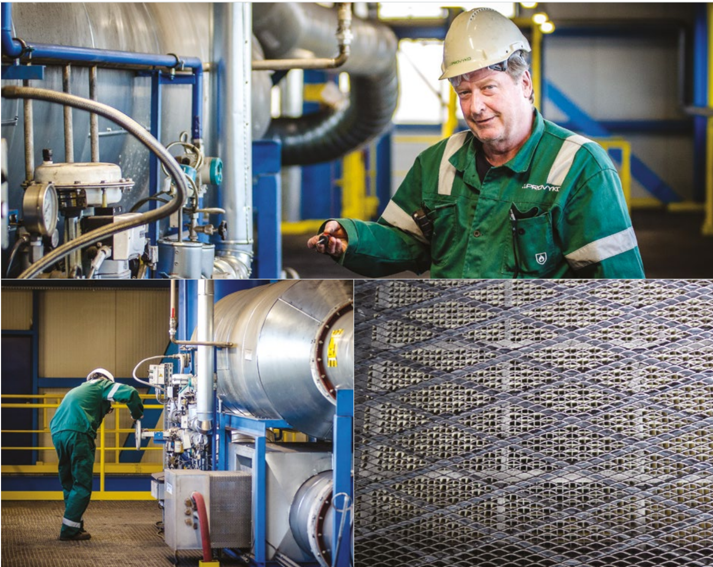
↑ Uvádění SCR systému do provozu ➤ Detail SCR modulu
