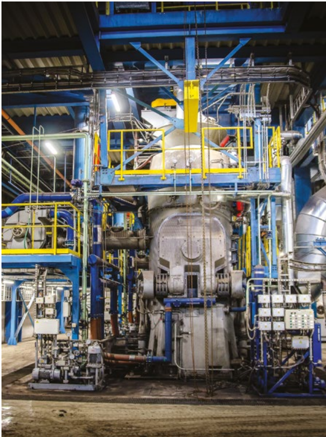
↑ Vertikální kladkové mlýny s výklopnými běhouny. Instalace v provozu energetického zdroje
